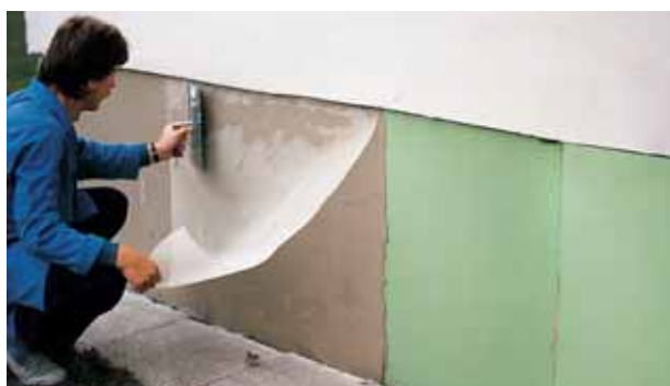
Fig. 20: Inserimento della rete in fibra di vetro nell'intonaco di fondo dello strato isolante dello zoccolo.
