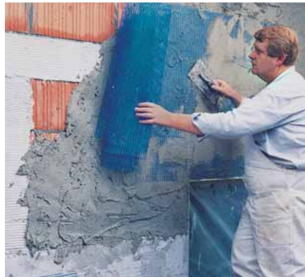
Fig. 22: Applicazione dell'intonaco di fondo e posa dell'armatura con rete in fibra di vetro sugli elementi strutturali in calcestruzzo isolati.
