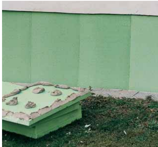
Fig. 31: Risanamento di una vecchia costruzione; incollaggio di lastre di Styrodur 2800 C con procedura di giunzione a punti sul bordo.
